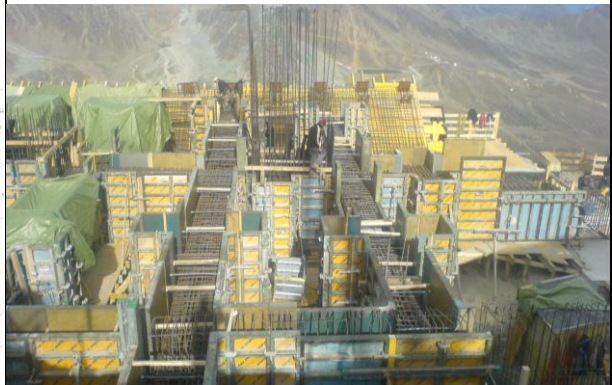
山顶站的承重架
