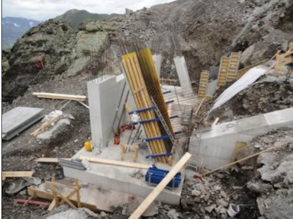
3S-MGD Pardatschgrat / Ischgl – Tower 5
