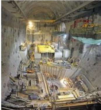
โรงไฟฟ้าใต้ดิน
