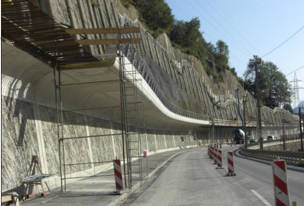
Steinschlagschutz für die Bundesstraße und die Fußgänger- und Radwege
